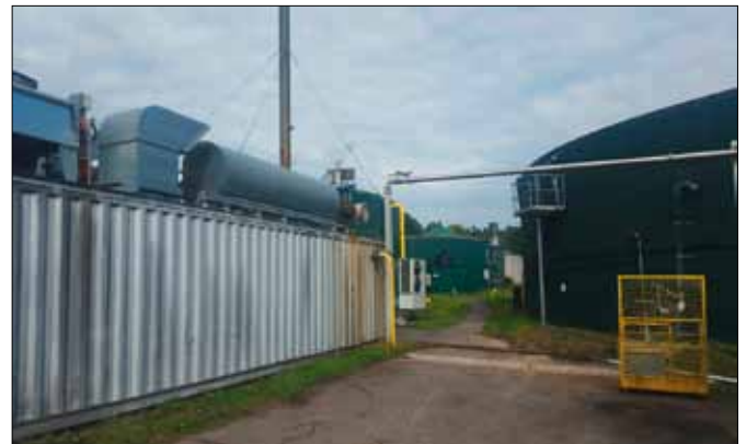
Ab Ende 2016 werden die sechs BHKW wieder eine Gesamtleistung von 3,3 MW erbringen.
